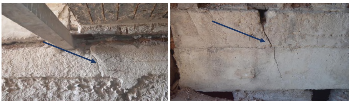
Рисунок 1 - Очаги разрушения железобетонного фундамента
